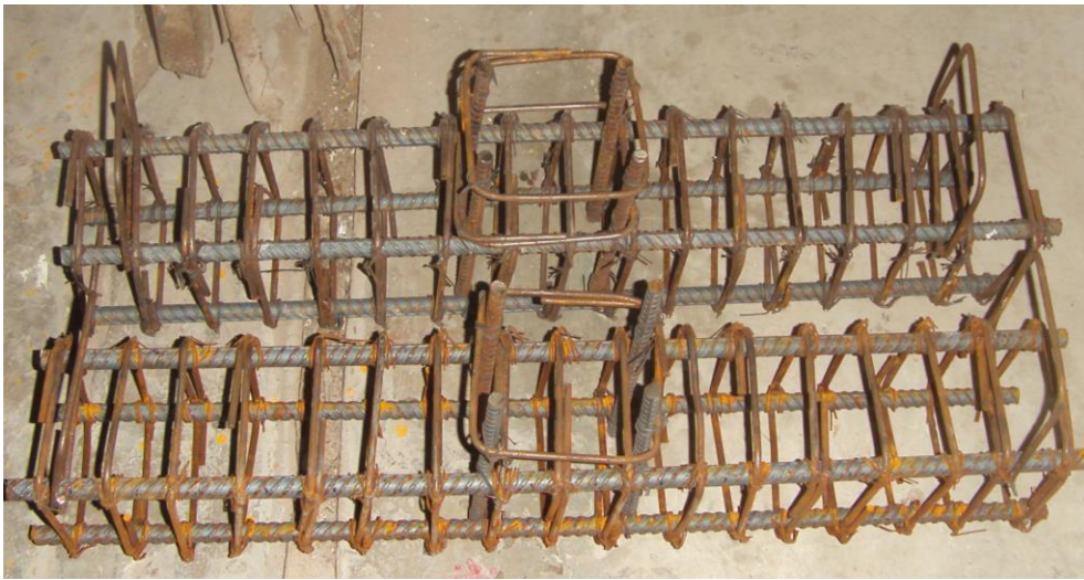
ภาพที่ 6.20 การผูกเหล็กเสริมในคานคอนกรีตเสริมเหล็ก
