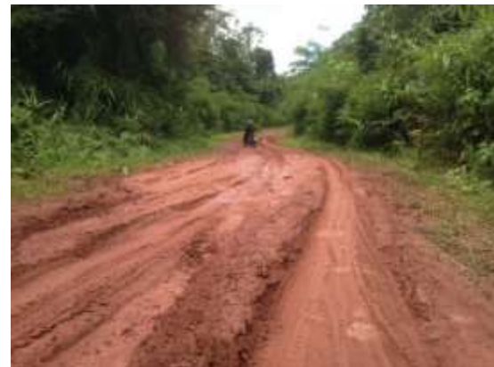
รูปที่ 2 สภาพถนนช่วงจุดผ่อนปรนถึงชุมชนบ้านห้วยสะแดง
