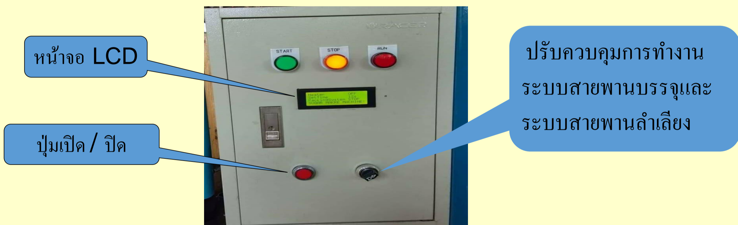
รูปที่ 1 ตู้ควบคุม
